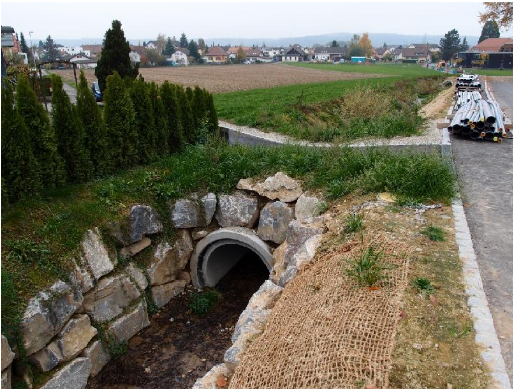
Foto 2 Neubau Durchlass D2 unterhalb der Brühlstrasse, Rohrdurchmesser: 1200 mm (Schwachstelle MUH041, Ansicht Fliessrichtung)
