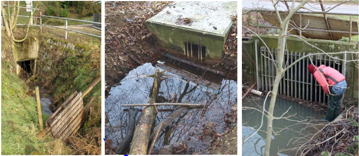
Abb. 15: Beispiele von verklausungsgefährdeten Querschnitten
