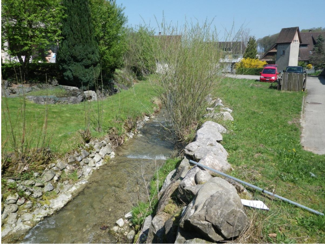
Foto 3: Wissenbach oberhalb der Brücke Büntweg im Bereich mit rechtsseitig erhöhtem Ufer. Der bachnahe Teil des linksseitigen Gartens wird für die Berechnung der Abflusskapazität mitberücksichtigt
