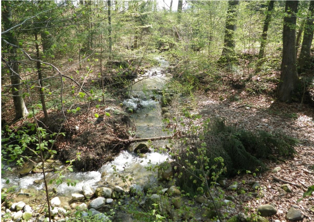
Foto 1: Wissenbach in der Tobelstrecke oberhalb von Benzenschwil, Blick gegen die Fliessrichtung. Äste und umgefallene Bäume/Stauden sind vom Unterhalt zu entfernen.
