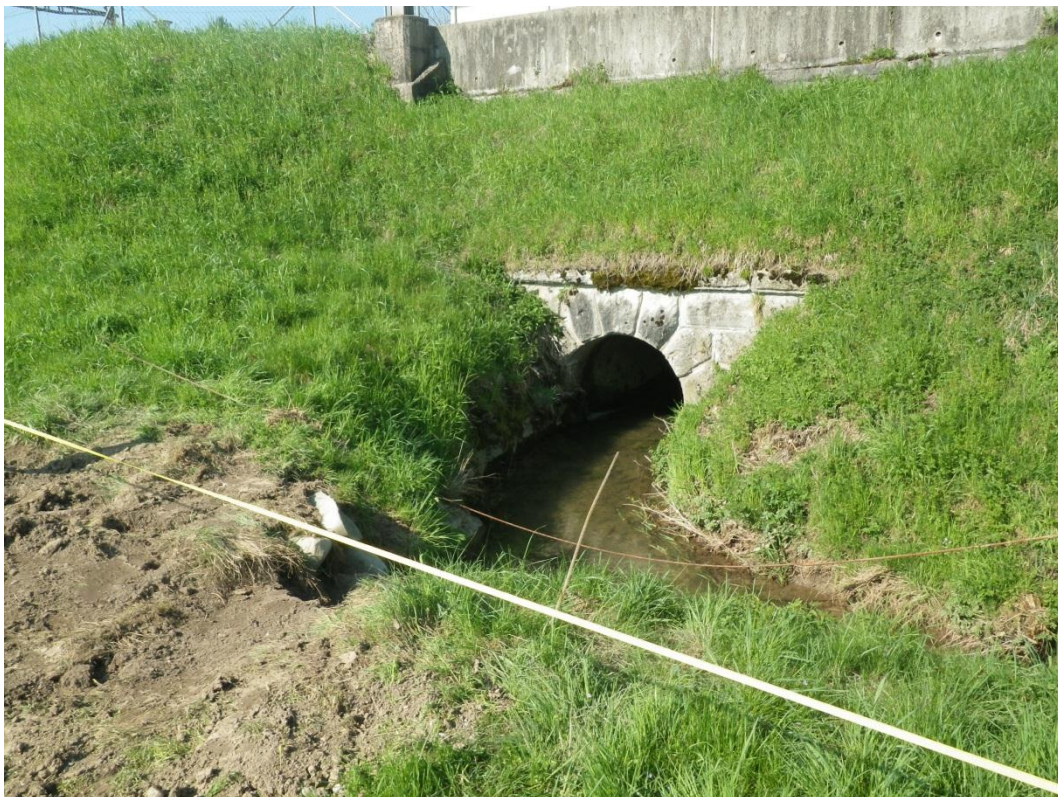
Foto 10: Durchlass SBB des Bünthenbachs, welcher im Projektperimeter weiterhin eine Überflutung ab dem HQ_{100} verursacht.
