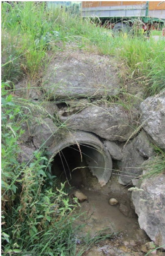
Abbildung 9 Einlauf Durchlass Bahnhofstrasse (60er Rohr), Schwachstelle ZH-HOH-2
