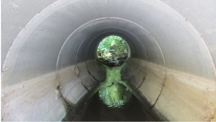
Abbildung 8 Durchlass bei der Parzelle 91 (120er Rohr), Schwachstelle ZH-HOH-1
