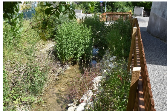
Foto 6, offenes Gerinne vor Schwachstelle de-str-4, Blick in Fließrichtung
