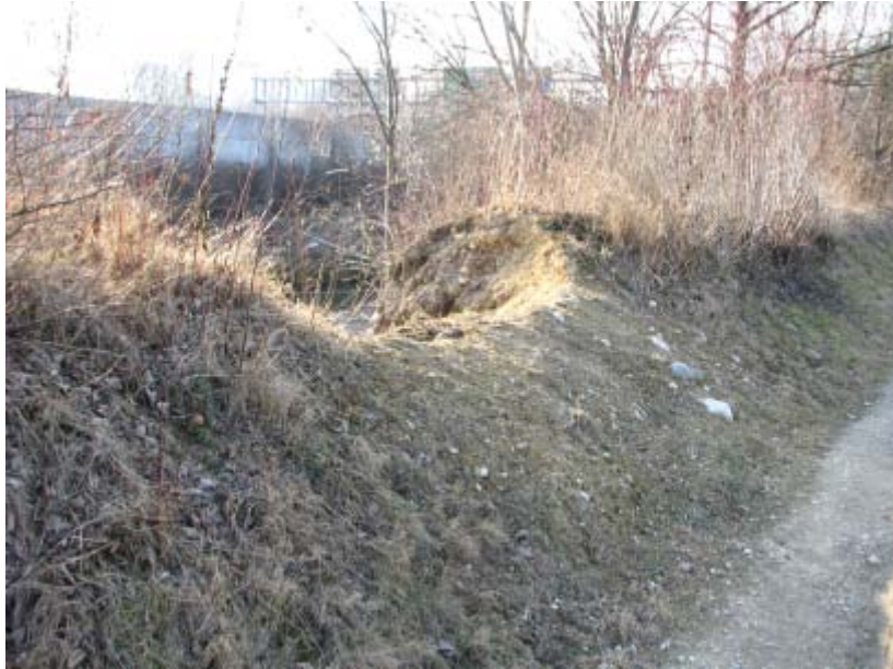
Abb. 13 Uferanriss am Damm der Wigger im Jahr 2008. Der Damm wurde umgehend wieder saniert.
