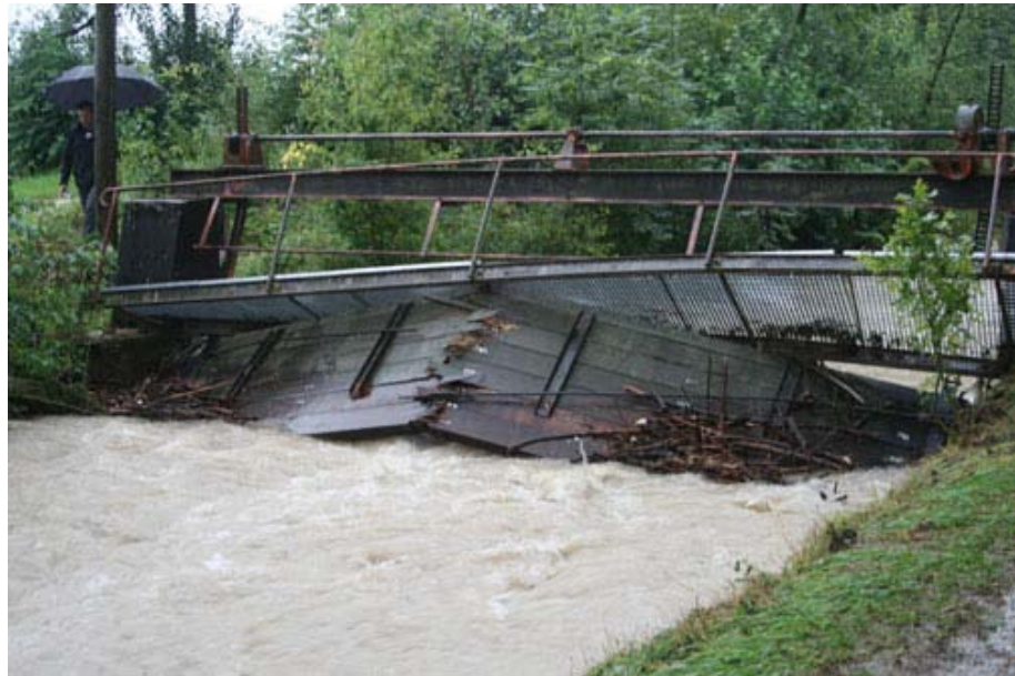
Abb. 7 Beschädigung des Einlaufschützes am Tychwehr beim Hochwasser vom 8. August 2007 (Foto Feuerwehr Zofingen).
