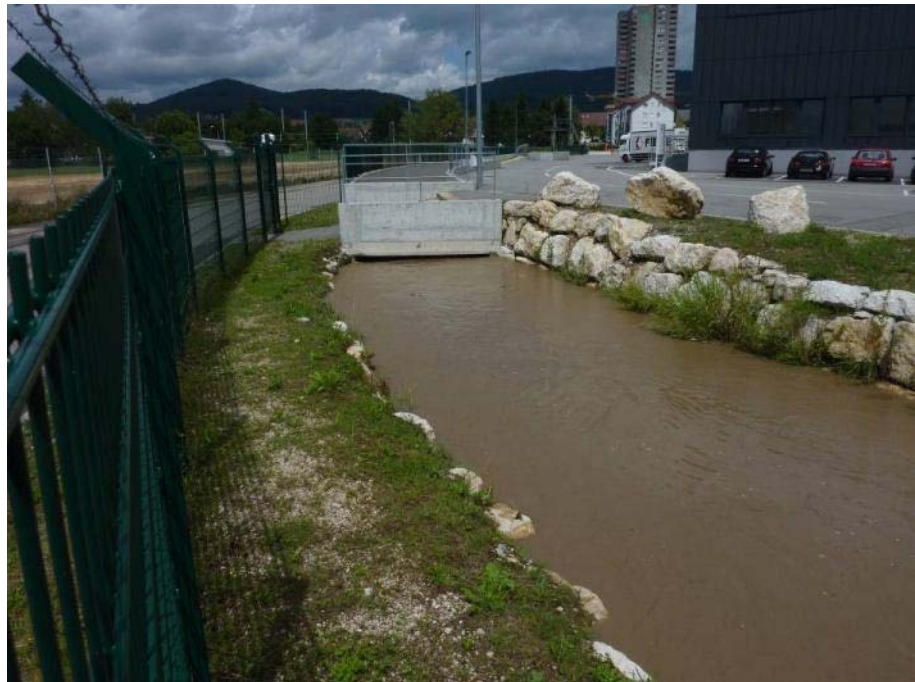
Abb. 18 Ausgeschöpfte Abflusskapazität der zweiten Eindolung FIEGE am 29.7.2010 (kleineres Wiggerhochwasser mit ca. 100 m³/s).
