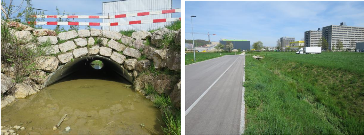
Abb. 3: Bachlauf im Abschnitt 2: Links: Durchlass Hofschriberstrasse, Rechts: Offenes Gerinne entlang Strasse „Gass“.
