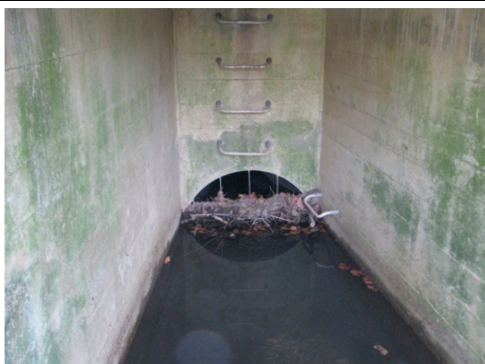
Innerer Rechen vor Massnahmen (man beachte die Verklausung)
