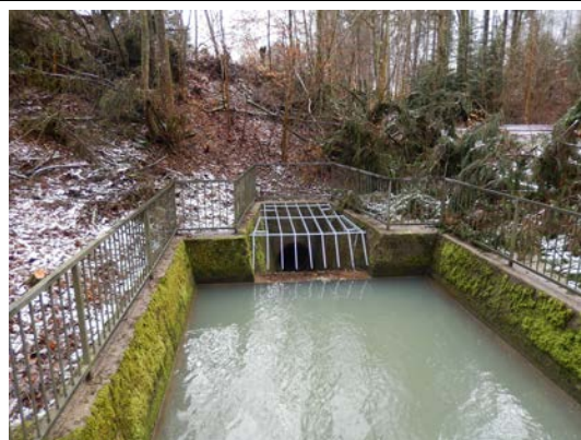
Tannenbächlein mit neuem Einlaufrechen
