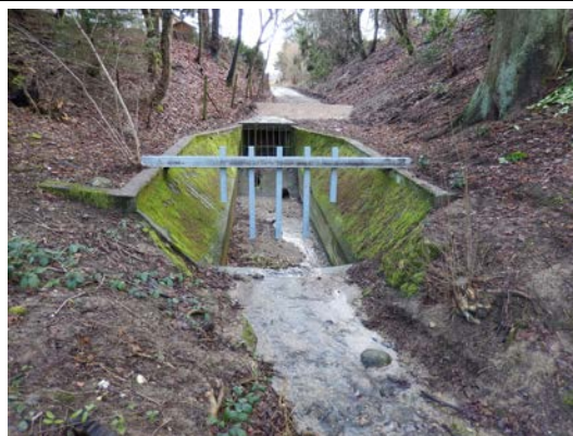
Grobrechen und geräumter Rückhalteraum
