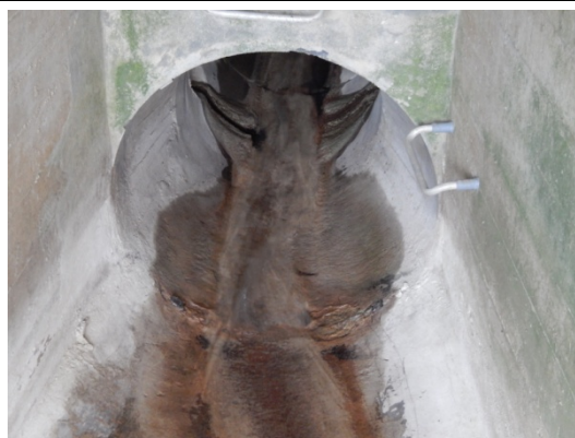
Entfernter Rechen am Rohrübergang
