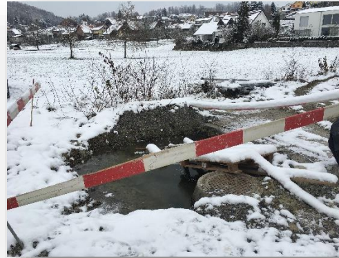
Abwasser aus Baugrube Bild: Schadendienst AfU
