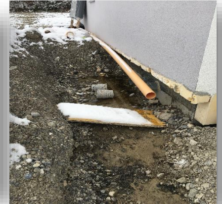
Grundwasser während Bauarbeiten Bild: Schadendienst AfU
