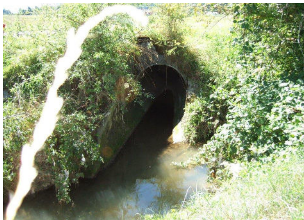
Abb. 10: Einleitung RB „Balzenmatt“ aus dem Regenklärbecken bei Riniken.
