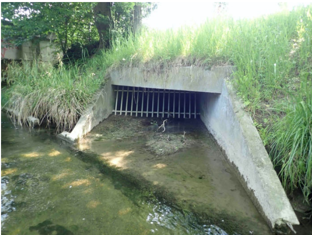
Abb. 7: Einleitung der Entlastung aus dem Regenbecken RUB Bünzmatt, Wohlen. Koordinaten: 2662794 / 1245178.
