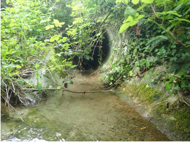
Abb. 17: Einleitung des Regenüberlaufes HE 110, Villmergen in den Hinterbach. Koordinaten: 2661127 / 1244416.
