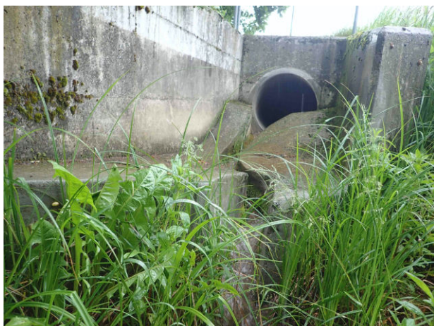
Abb. 31: Einleitung aus des Regenüberlaufes RA 9 in Reinach. Koordinaten: 2656085 / 1235086.
