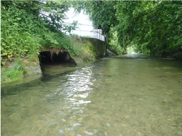
Abb. 17: Entlastungsöffnung des Regenbeckens RUB Eien-Holenweg in die Wyna. Koordinaten: 2655224 / 1235303.
