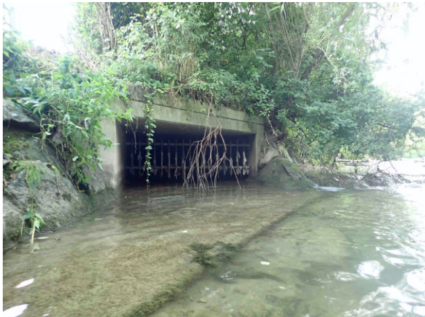
Abb. 7: Einleitung aus dem Regenklärbecken RUB Griensammler in Reinach. Koordinaten: 2655402 / 1234806.
