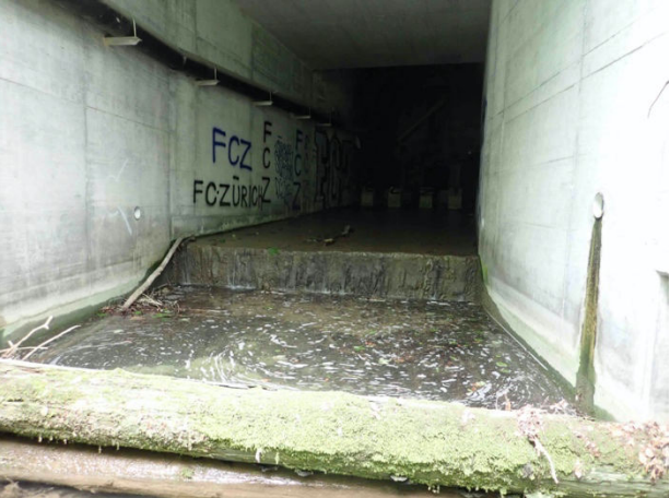
Abb. 11: Eindolung des Pflanzerbaches mit Einleitung HE 46 (weiter hinten, nicht sichtbar), Widen. Koordinaten: 2669276 / 1246043.
