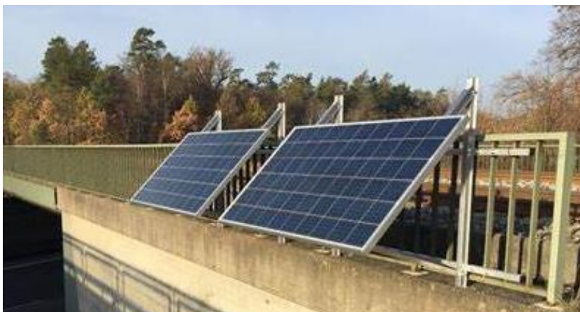
Abbildung 9 Beispiel von PV-Modulen an einem Brückengeländer montiert.
