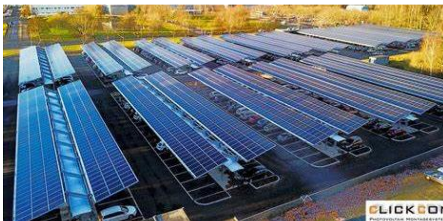
Abbildung 11 Beispiel für PV-Überdachungen von Parkplätzen
