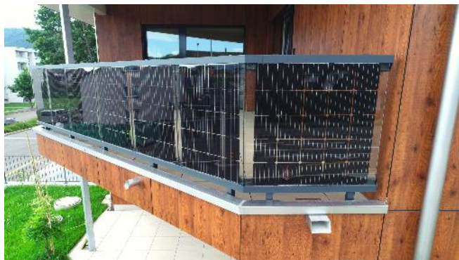
Abb. 10: PV-Anlage in Balkongeländer
