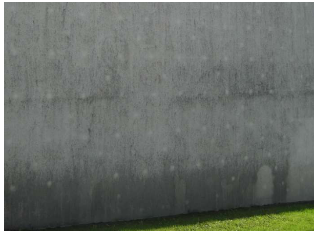
Abbildung 41: Schlecht ausgeführte Fassadendämmung [Quelle: B&E]
