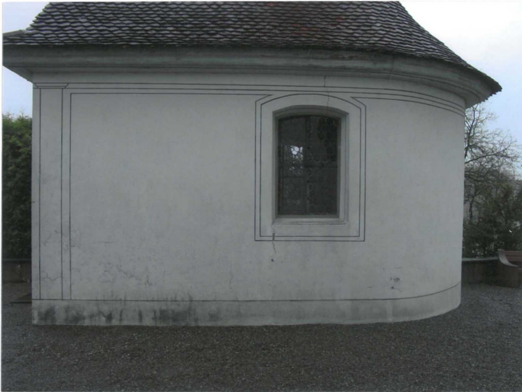
Unten und Oben: Vorzustand
