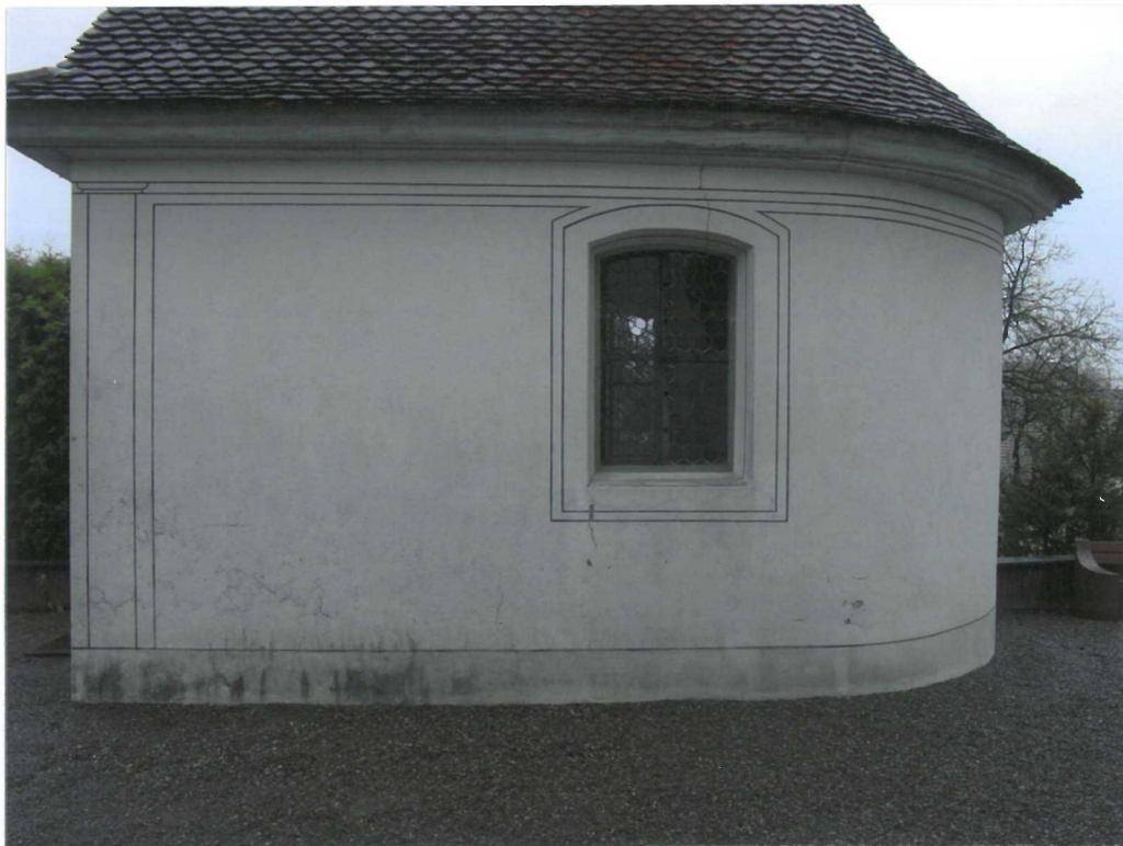
Unten und Oben: Vorzustand
