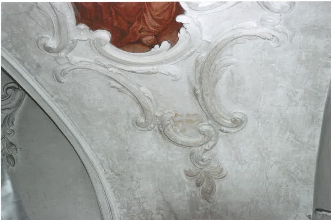
Oben: Zugepappte Stukkaturen. Unten: Partiiell freigelegte Stukkaturen.
