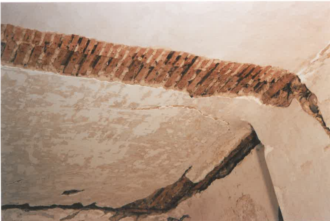
Oben und Unten: Chor: Im linken Seitenjoch wurde der lose Putz ausgebaut. Grössere Risse wurden fachgerecht geöffnet.
