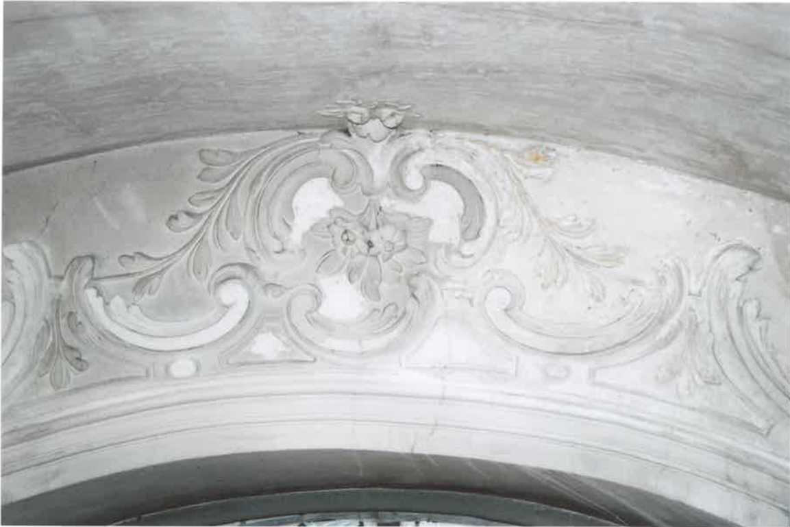
Oben: Chorbogenkartusche freigelegt und Fehlstellen ergänzt. Unten: Chorbogenwand wird von mehreren Farbschichten freigelegt.
